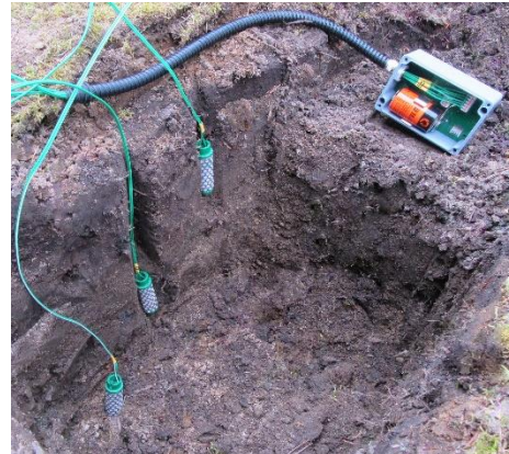
Die Elektronik kann bei Bedarf komplett unterirdisch und damit unsichtbar eingebaut werden.
